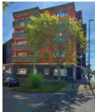
Am Eckhaus an der Jahn-Ecke Deichstraße 55 sind kleinere Fassadenmängel festgestellt worden, die in nächster Zeit ausgebessert werden.
